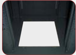
Entrada cable suelo
